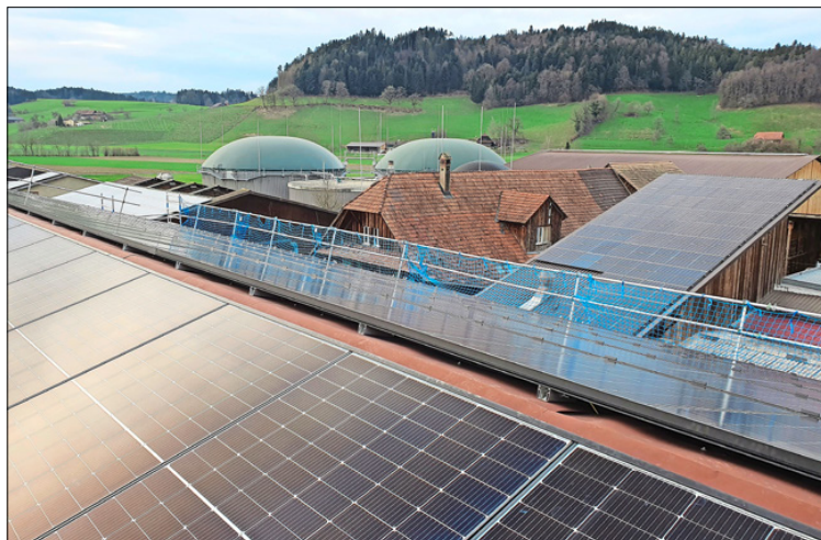
Viel Solarstrom produzieren die Module auf den Dächern des Wiggerhofs. Im Hintergrund die grosse Biogasanlage. (Bild zVg Wiggerhof)
